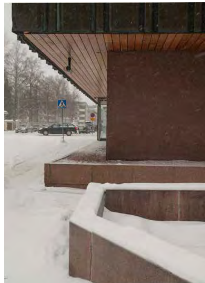
Graniittimuuria rakennuksen eteläpuolella ja samalla materiaalilla verhottu istutuslaatikko ensimmäisen kerroksen sisäänvedon kohdalla. Laatikossa alunperin olleista kasveista on jossain vaiheessa luovuttu.
